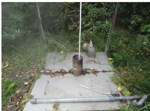
写真 4 温泉ホテル裏の蒸気井
