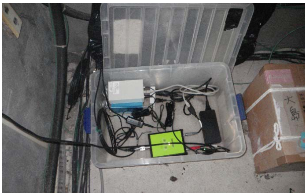
写真 11. ETBT の受信機の交換後。
