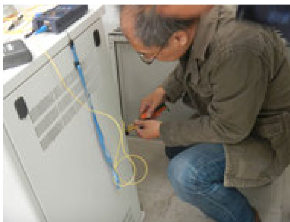
写真4 光ケーブル空き芯線の通信テスト
