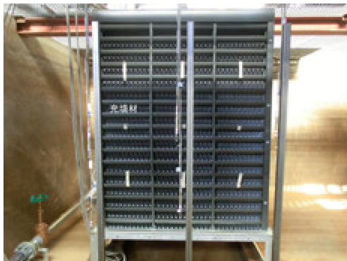
写真6. 冷却塔正面と充填材
