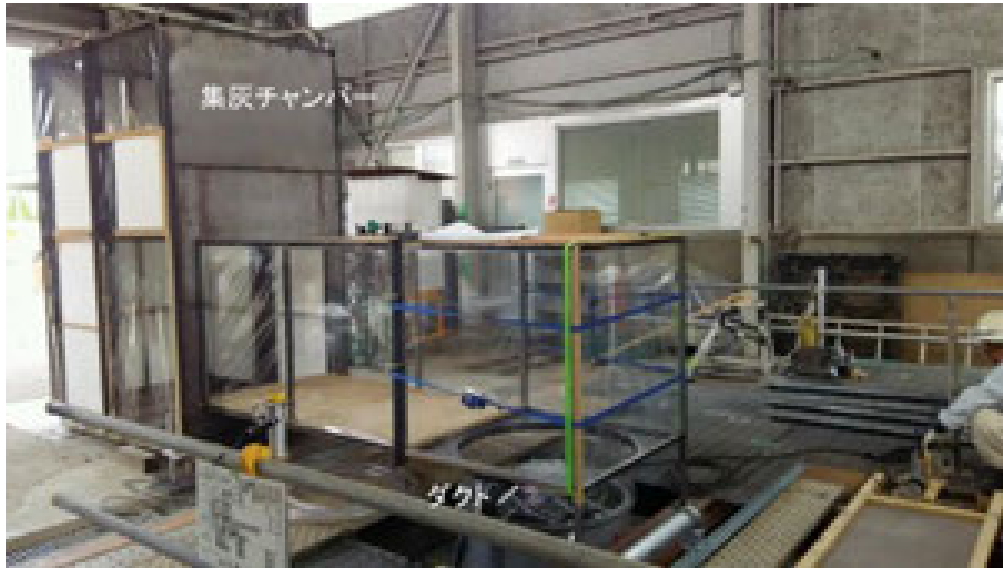
写真4. 排気ダクトと集灰チャンバー
