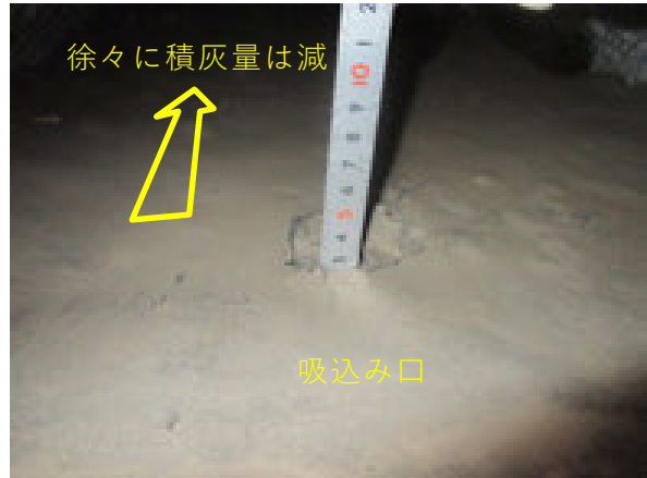
写真13. 吸込口付近積灰深 (実験終了時)
