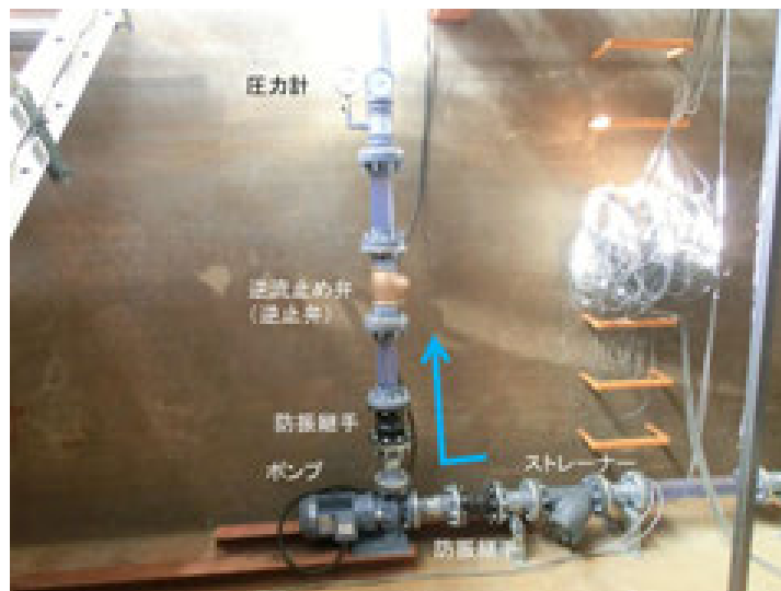
写真8. 冷却水ポンプ及び配管
