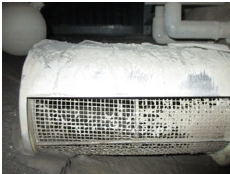
写真16. 冷却水配管への吸込口のストレーナ(実験終了後)
