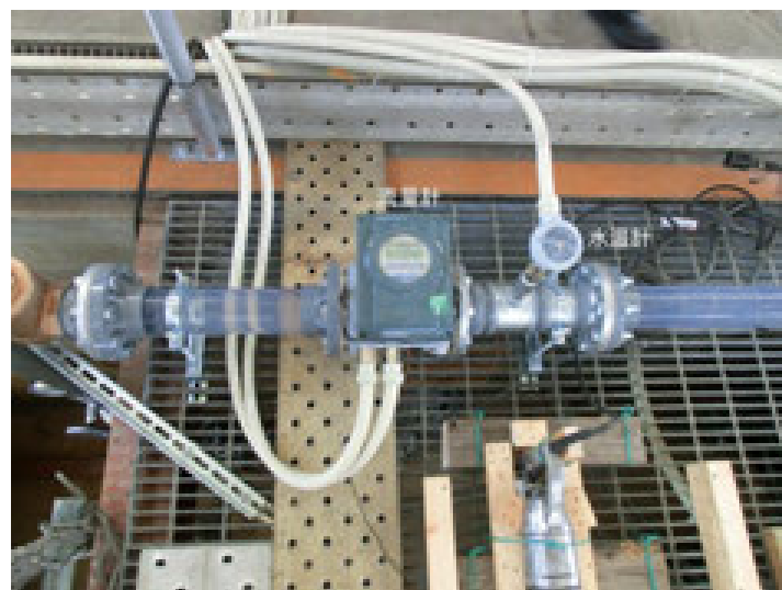
写真9. 流量計，水温計，透明配管部分
