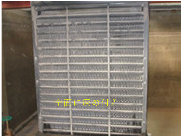
写真12. 吸込口全景着灰 (実験終了時)
