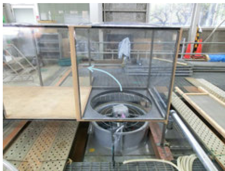
写真3. 冷却塔送風機と排気ダクト（矢印は排気機吹出す方向）
