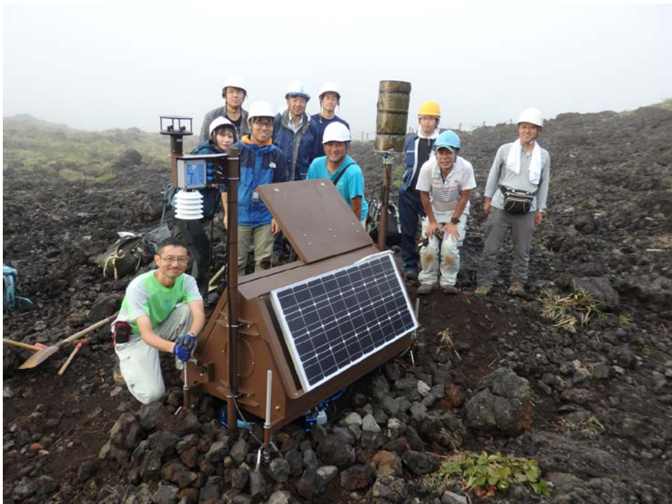
本事業で実施した伊豆大島緊急観測の際に新たに設置した火山土壌ガス流量連続観測装置。本事業の参加者や気象庁職員が協力して三原山山頂に設置した。平成30年9月2日撮影。
