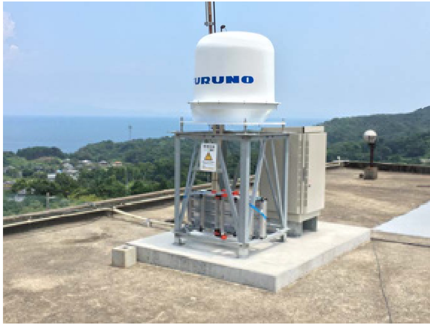
図 2 レーダーの設置状況。鹿児島県立錦江湾高等学校に設置したもの。
