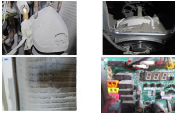
図 21 乾燥灰実験後の熱交換フィンおよび内部の状況
