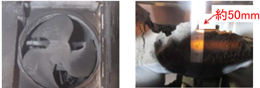
図 22 室外機ファンに堆積した火山灰
