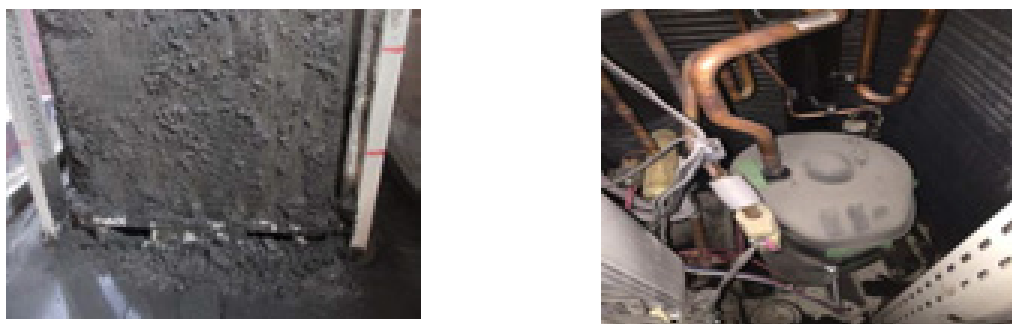
図 27 火山灰のフィンへの付着(左)と 室外機の内部状態(右)
