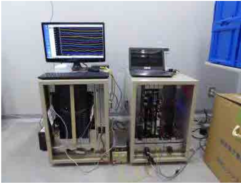
写真 2 観測室内の光送受信装置の設置状況
